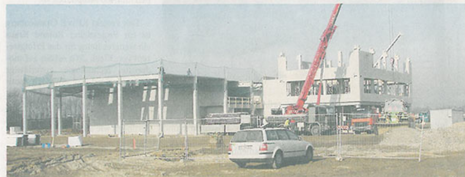
Beim Neubau des MAN-Truck-Centers Rheinland in Frechen war – gerade was die Dämmung angeht – eine erprobte und nachhaltige Lösung gefragt.
